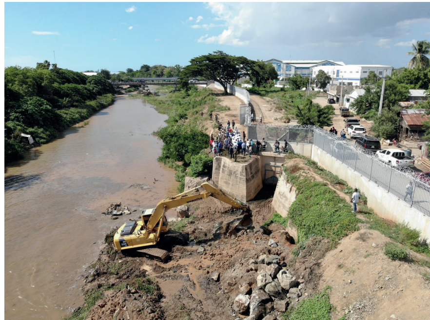
Rehabilitación de la toma de agua de La Vigía o La Aduana. Esta obra fue autorizada por el gobierno dominicano en respuesta a la construcción del canal en las llanuras de Maribaroux.
