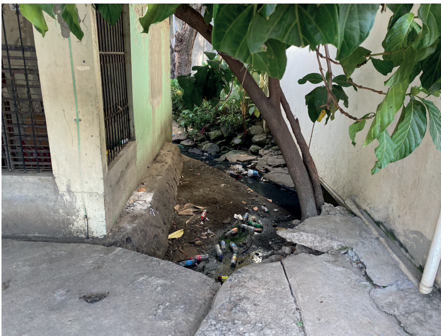
Ejemplos del mal estado del sistema de drenaje en el casco urbano de la provincia.
