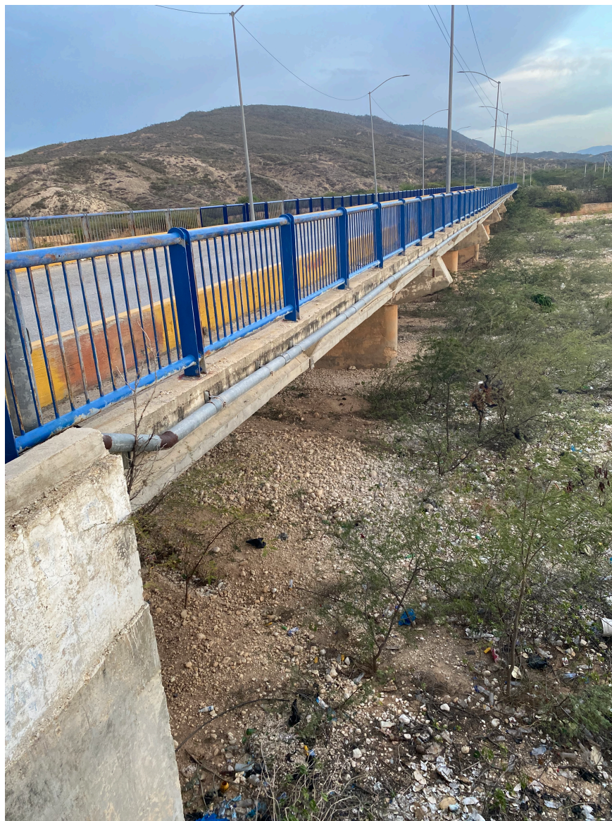
Nuevo puente construido sobre el Río Blanco después de la inundación del 2004.
