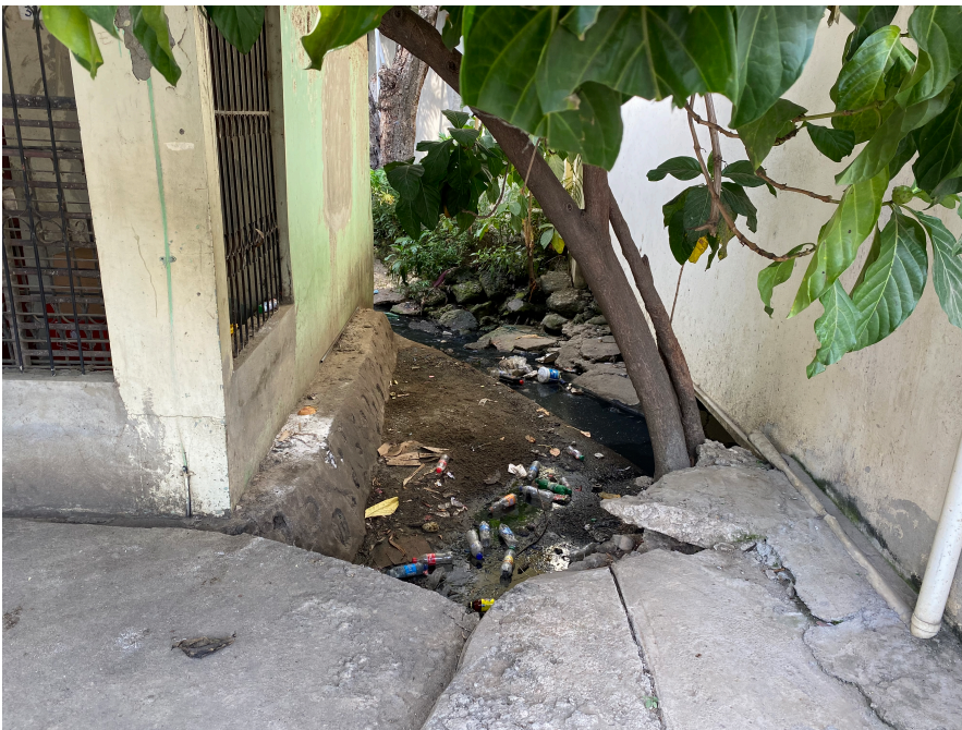
Ejemplos del mal estado del sistema de drenaje en el casco urbano de la provincia.
